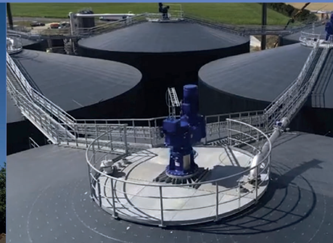
Tanques de aço parafusados biodigestores
